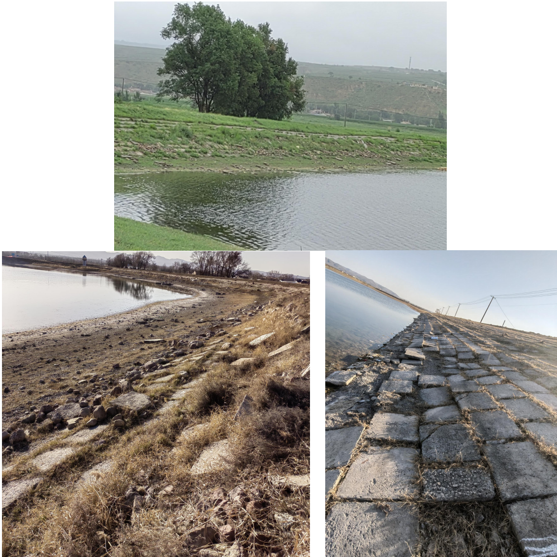
图 4-1 上游坝坡预制砼板损坏严重
