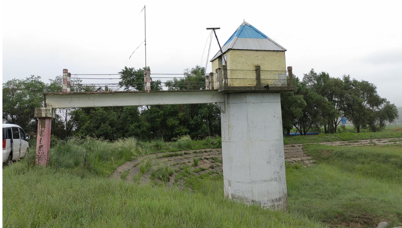
图 4-3 现状水塔高出坝顶
