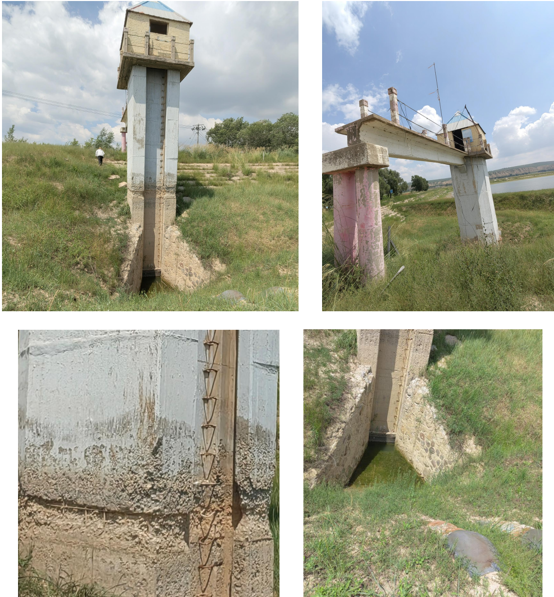
图 4-4 水塔塔身钢筋外露
