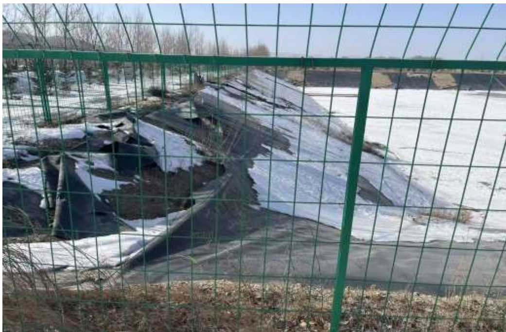
图 2.6-2 潘家庄蓄水池防渗膜破损严重（2）
