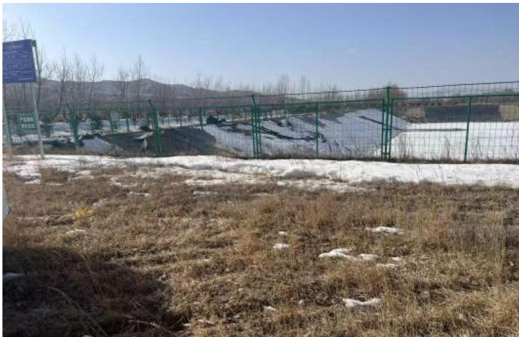
图 2.6-1 潘家庄蓄水池防渗膜破损严重（1）
